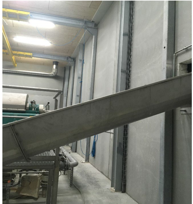
Tværsnegl til slamlager
