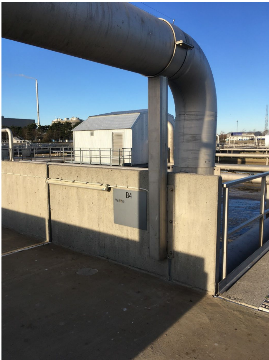
Blæser bygning samt rørføring ved gangbro
